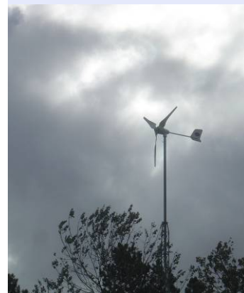
Εικόνα 17. Αυτόνομο σύστημα με μικρή Ανεμογεννήτρια
